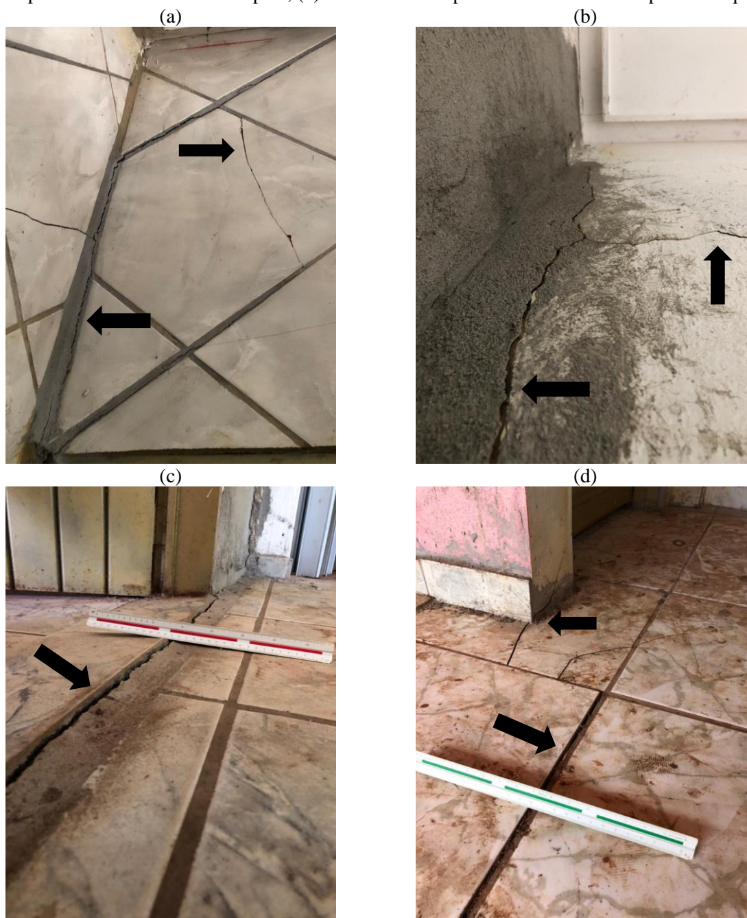
Figura 8 – Fissuras provocadas pelos movimentos de retração e expansão do solo: (a) fissuração no vértice superior na parede interna; (b) fissura no canto superior da parede, próxima ao pilar; (c) rompimento e rebaixamento do piso; (d) afastamento do piso e fissuras causadas pelo recalque.
