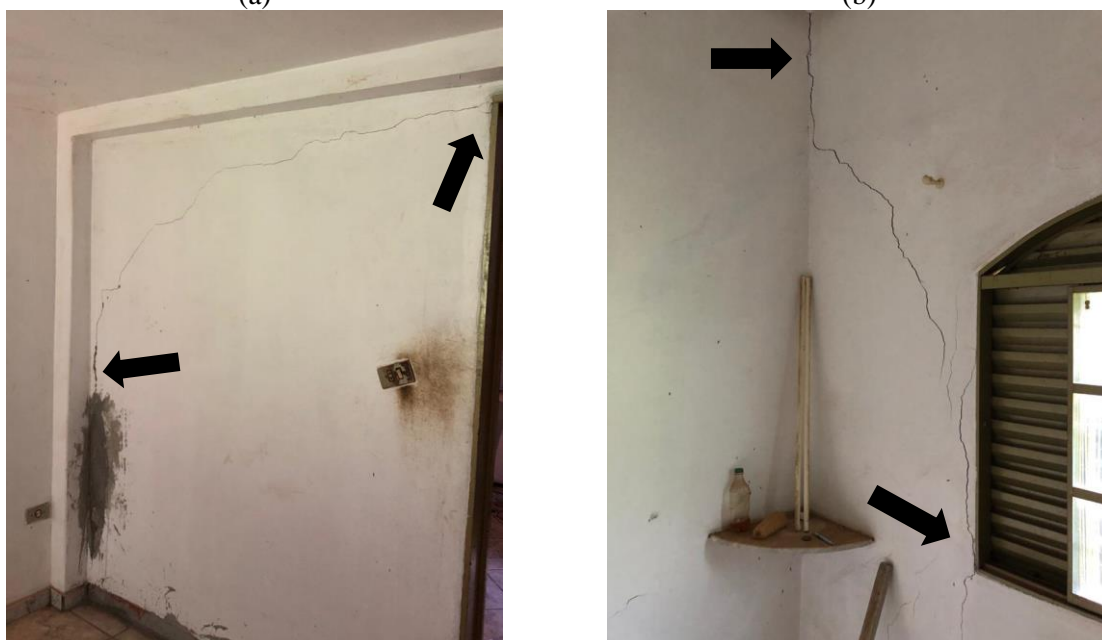
Figura 7 – Fissuras devido a deflexão de componentes estruturais: (a) fissura inclinada em direção ao ponto crítico; (b) fissura com variação da abertura.
