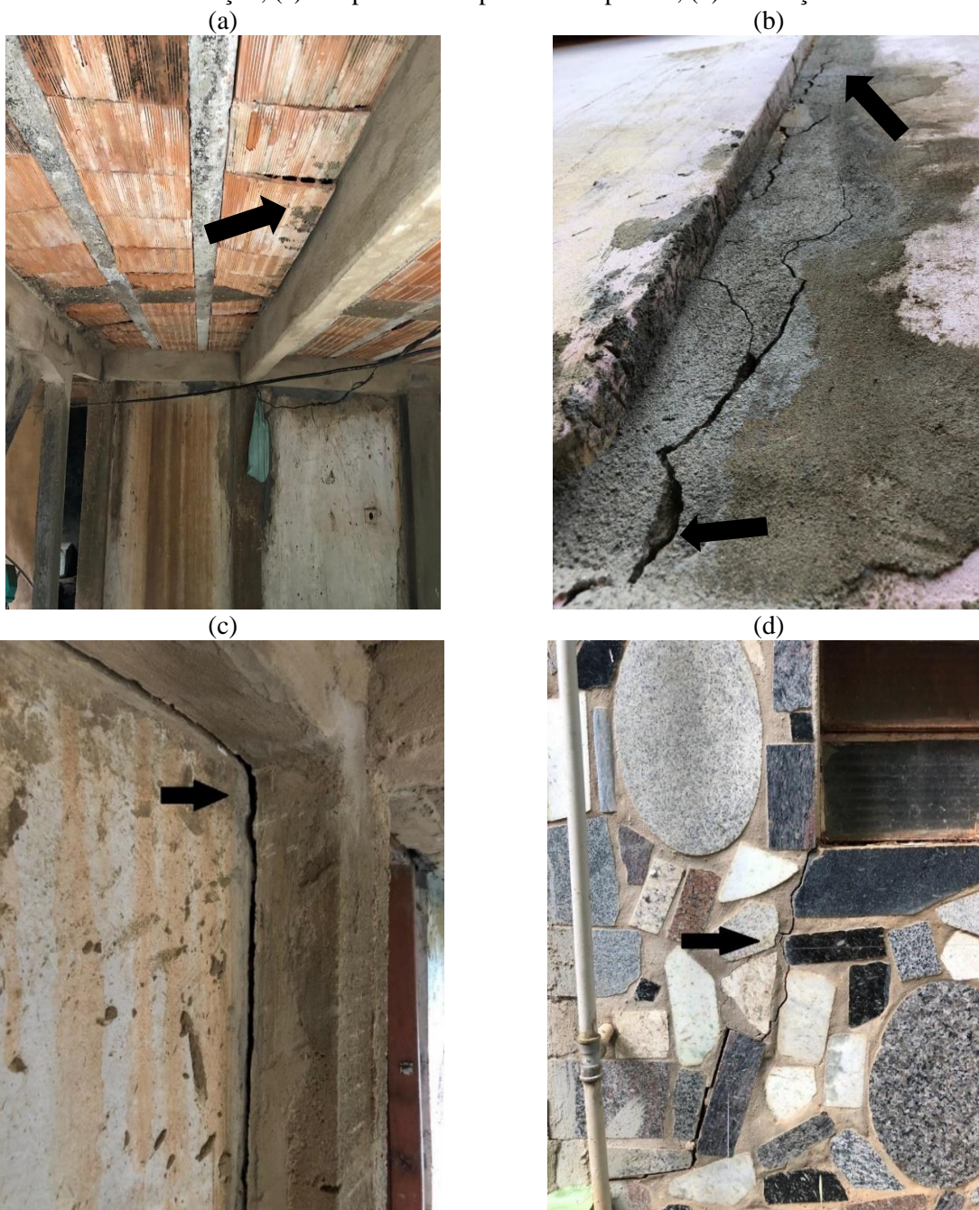
Figura 6 – Patologias encontradas no pavimento inferior da edificação: em (a) deformação na laje; (b) fissuração; (c) rompimento do pilar com a parede; (d) fissuração.
