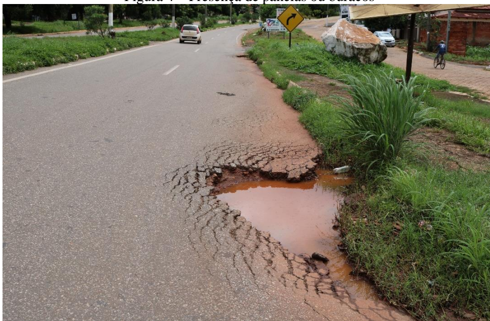
Figura 4 – Presença de panelas ou buracos
