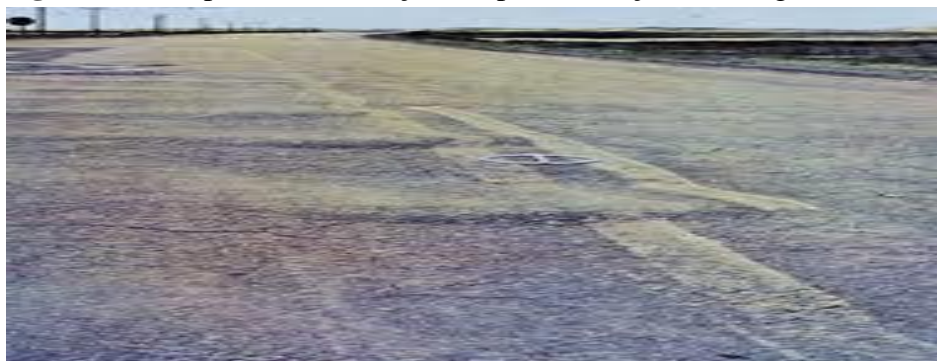
Figura 7 -Exemplo de deformação em pavimentação semirrígida.
