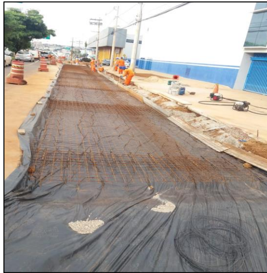
Figura 10: Disposição da manta geotêxtil e armaduras de aço (itens 4 a 4.3 apêndice b)
