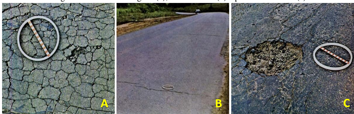
Figura 2 – Trinca interligada (a), trinca solada (b) e panela ou buraco (c)
