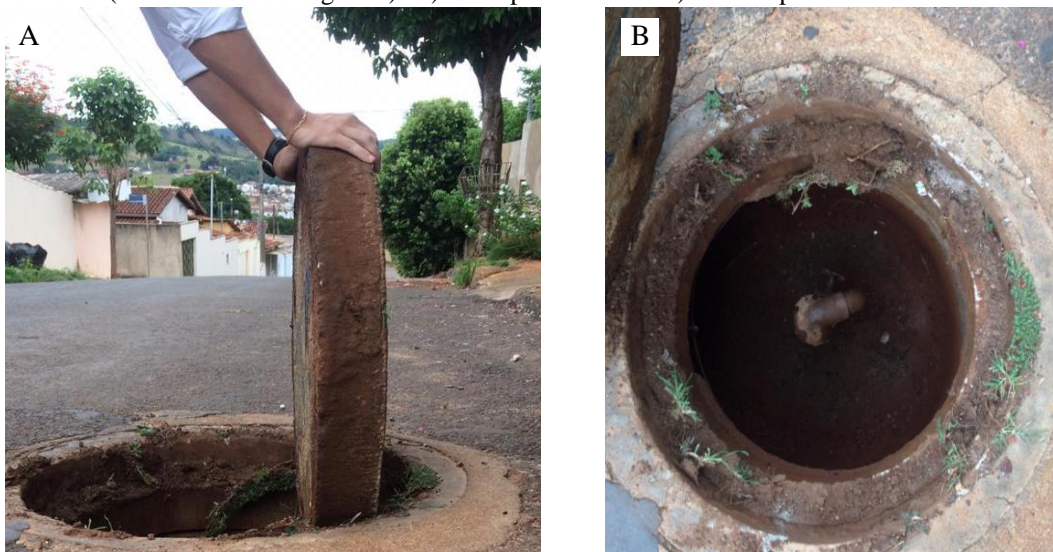
Figura 9 – Válvula ventosa instalada corretamente após realização de levantamento topográfico do terreno (VENTOSA 2 na Figura 6): A) Vista para Rua 32 . B) Vista superior da ventosa instalada.
