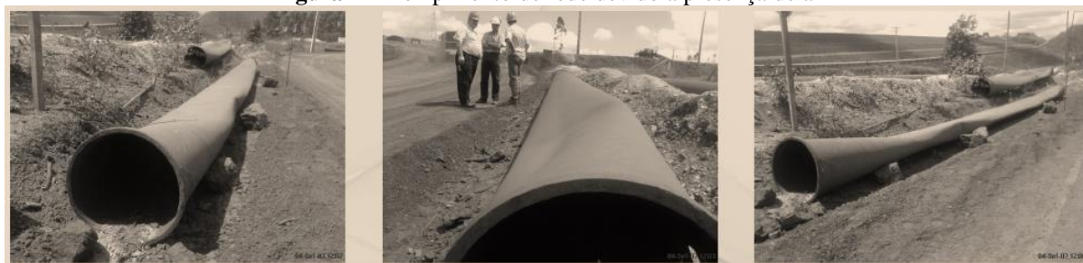
Figura 1 – Rompimento de rede devido a presença de ar
