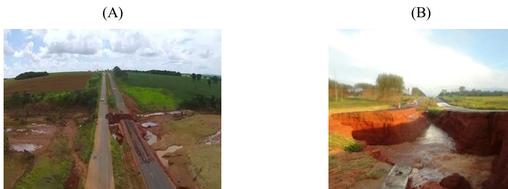
Figura 4 – Danos causados pelo rompimento da barragem
