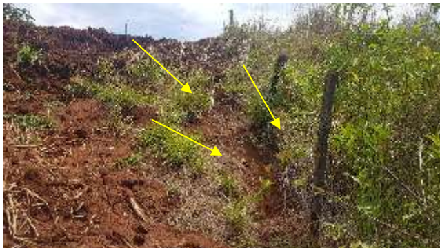
Figura 9 – Erosão no talude jusante
