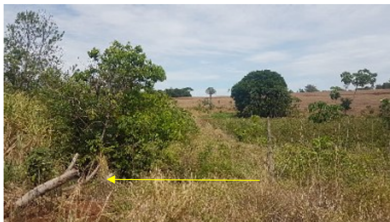
Figura 10 – Erosão no talude jusante
