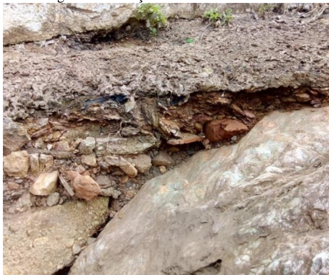
Figura 9 – Situação das camadas do asfalto
