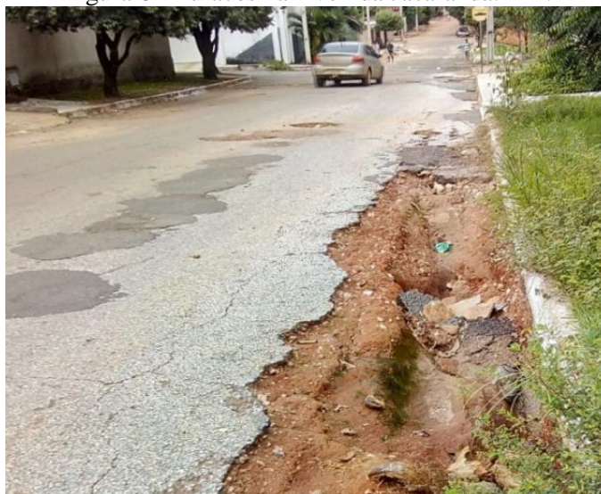
Figura 8 –Buracos na Avenida Jacarandá.
