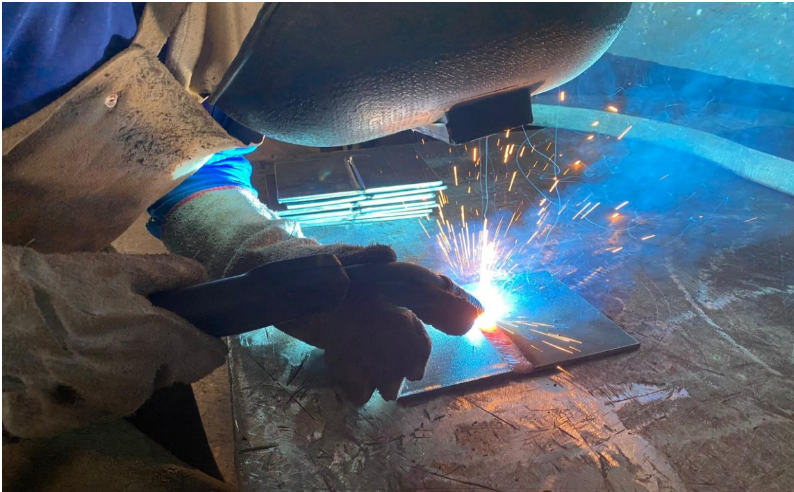
Figura 4 - Processo de soldagem MIG de um dos corpos de prova a serem analisados.
