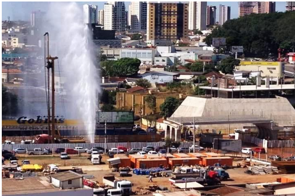
Figura 33 - Rompimento da adutora - Rampa 1
