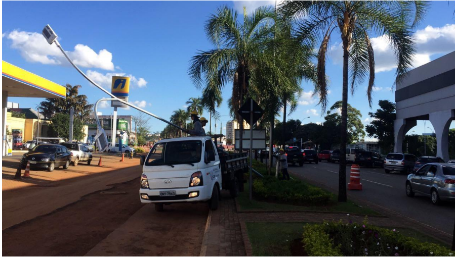
Figura 17 – Instalação da nova iluminação, próximo ao centro administrativo, na Av. Brasil Norte
