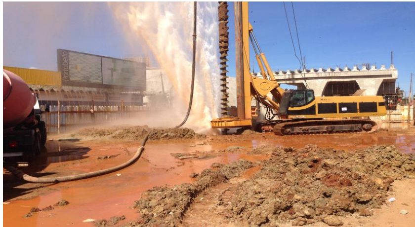
Figura 34 – Cravação de estaca causa rompimento da adutora na rampa 1
